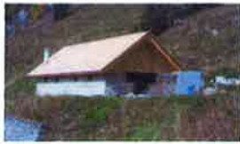
Chalet de Rafevex En travaux sinistré en 2013
